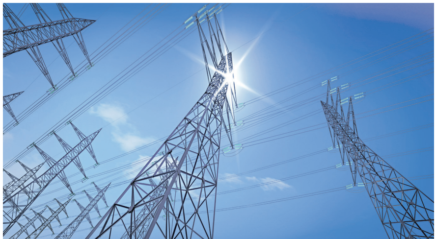
Noch Luft nach oben: Die Verteilnetzbetreiber lehnen die Einstufung der Kosten für den Redispatch als volatile Kosten ab. Foto: © peterschreiber.media/AdobeStock
